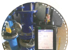
空調主機檢測
